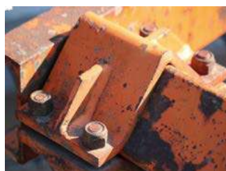
Corrosão em frestas
