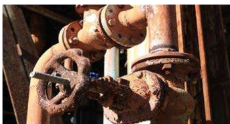
Corrosão em flanges
